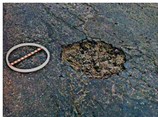
Fig 12 Panela ou buraco, DNIT (2003)
