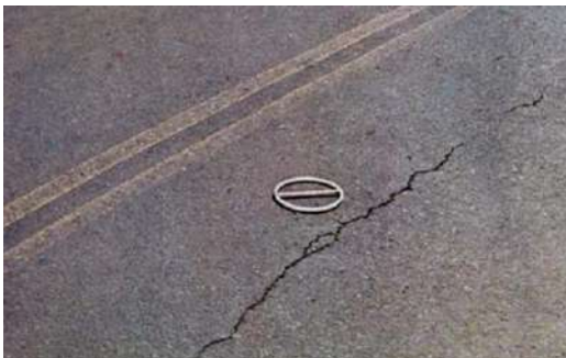
Fig. 3: Longitudinal crack (CNT, 2019)
