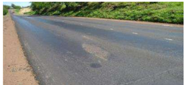
Fig 8 Asphalt exudation, DNIT (2003)
