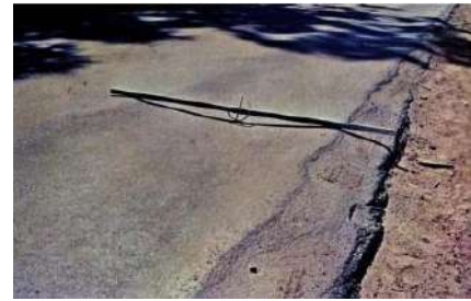
Fig 7 Afundamento da trilha de roda, DNIT (2003)
