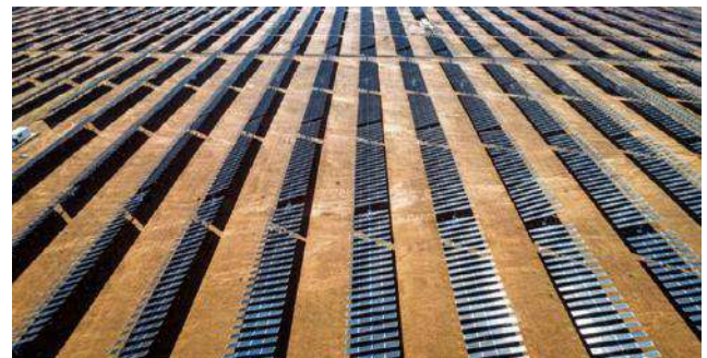
Fig.8: São Gonçalo Solar Park
