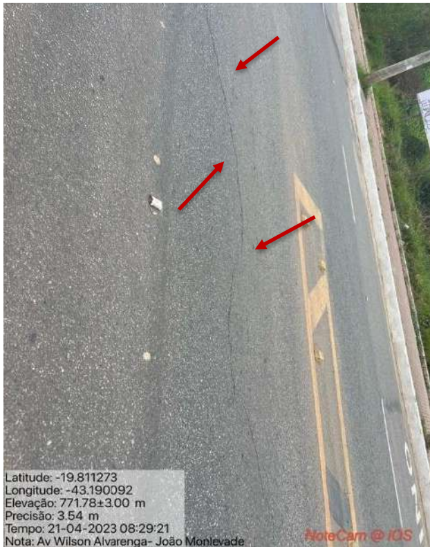
Fig.9 – Trincas Isolada Longitudinal Longa
