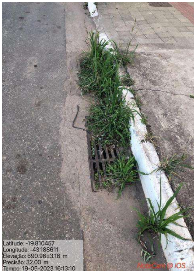
Fig.11 – Obstrução de dispositivo de drenagem
